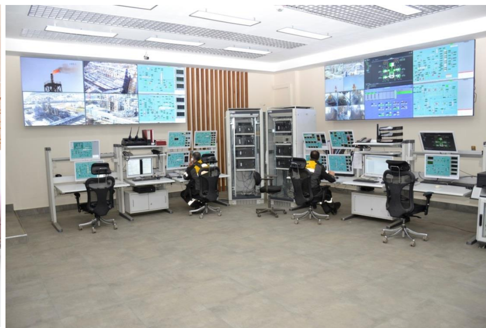
Рабочее место оператора технологических установок
